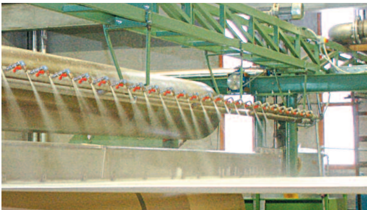
Impianto di lavaggio
